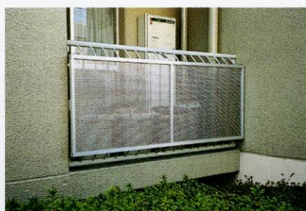
通風を妨げることなく外観もすっきりした。
